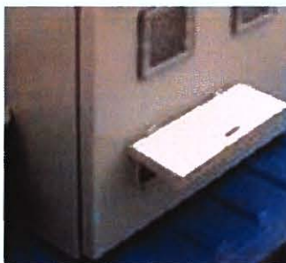
Figura 27: Portezuelas Breakers de Protección de Acometidas
